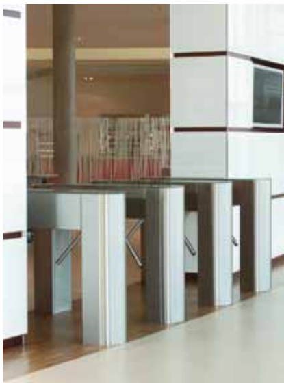
Im Rezeptionsbereich zur Pförtnerunterstützung
