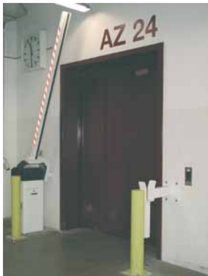
Schrankeneinsatz im Innenraum zur Sicherung eines Lastenaufzugs
